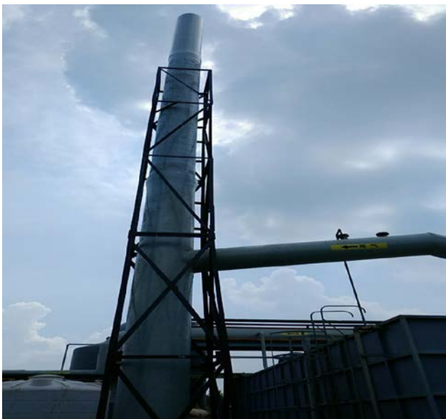
污水站生物箱排气筒
