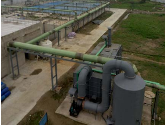
厂区污水处理站
