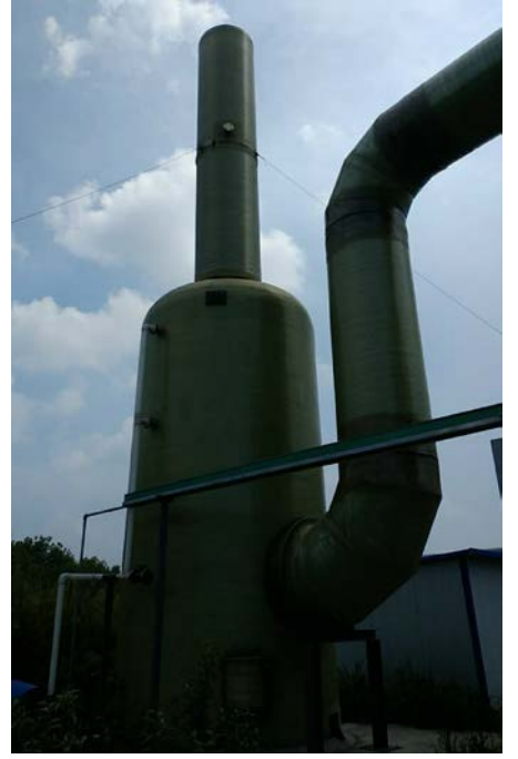
15m 高排气筒
