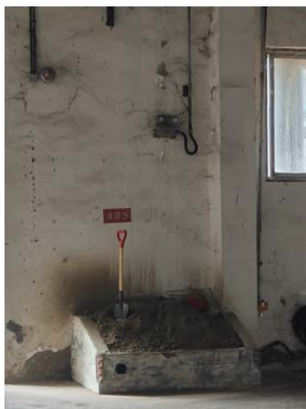
五硫化二磷车间消防砂
